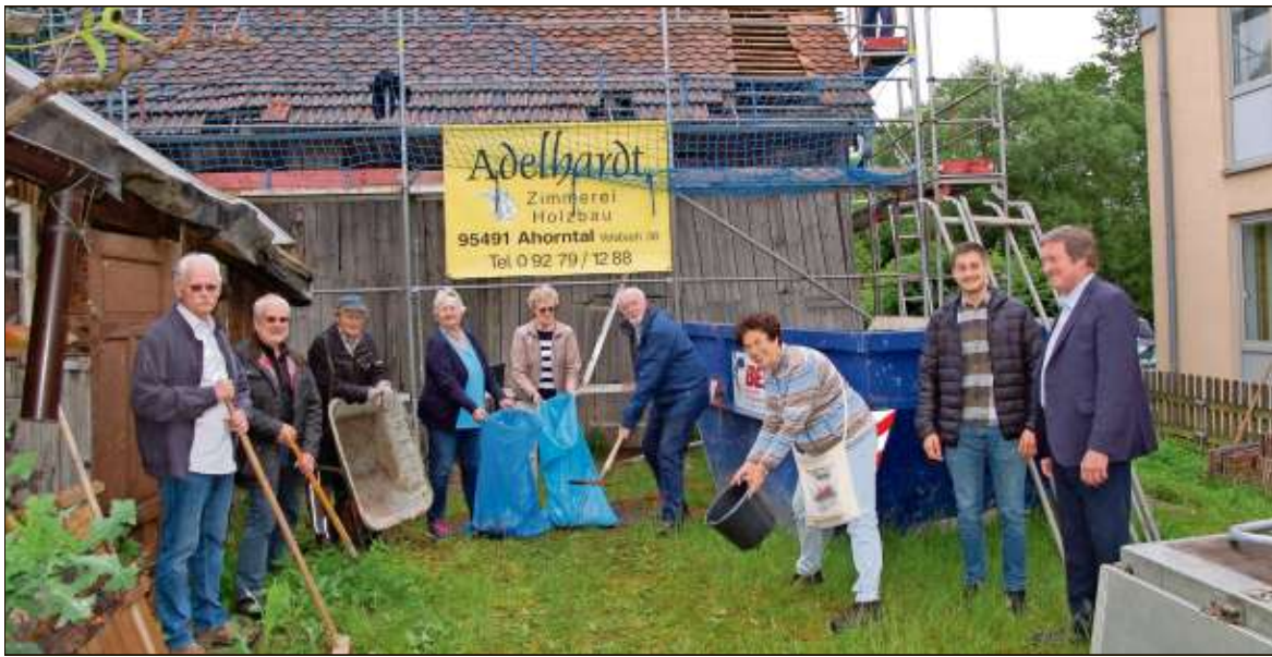
Am Donnerstag war Auftakt: Bereits im Vorfeld waren die Vorstandsmitglieder mit Vorsitzender Brigitte Trausch (Dritte von rechts) fleißig beim Ausräumen. Weiter von rechts Bürgermeister Karl Lappe und ILE-Manager Philipp Herrmann. Am Gerüst Zimmermeister Berthold Adelhardt. Foto: Dieter Jenß
